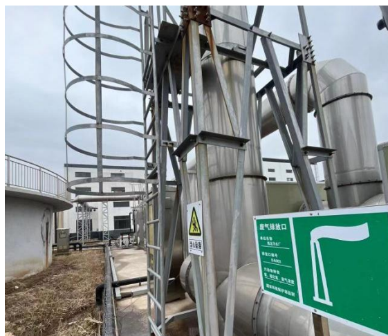
DA003 废气排口
