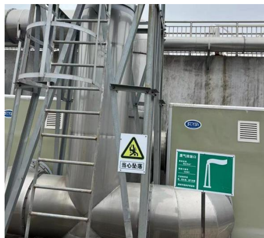
DA001 废气排口
