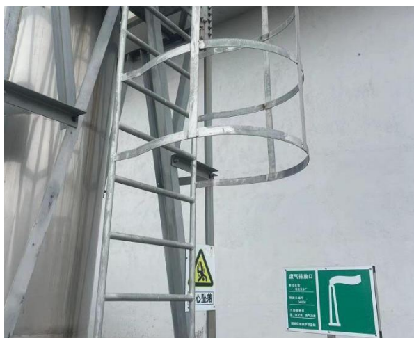
DA002 废气排口
