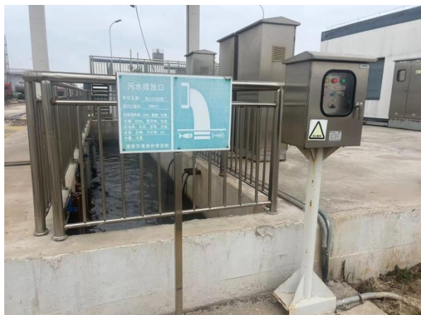
DW001 废水总排口
