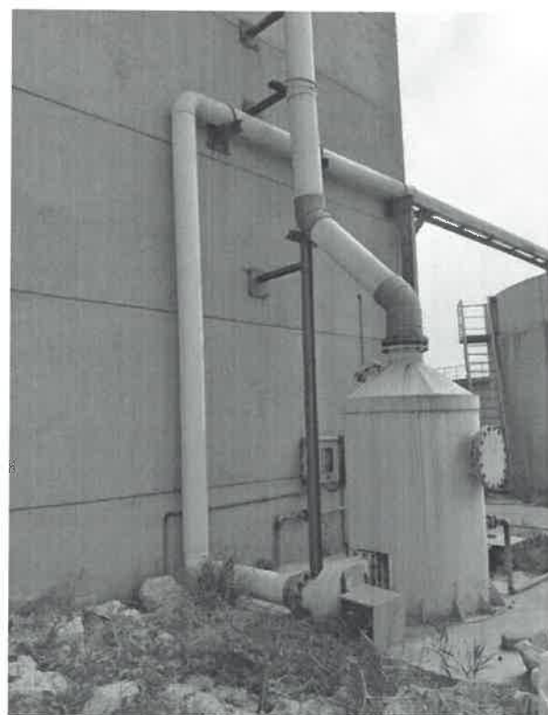
生物滤池除臭系统
